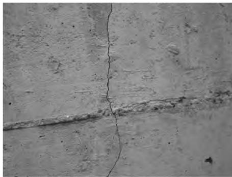
图1 现场裂缝照片
