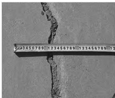
图 4 坝顶混凝土路面裂缝现状
