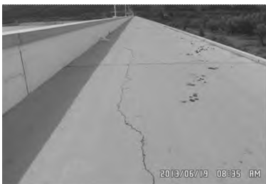
图 3 主坝混凝土路面裂缝走向
