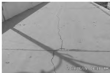
图 2 主坝混凝土路面裂缝走向
