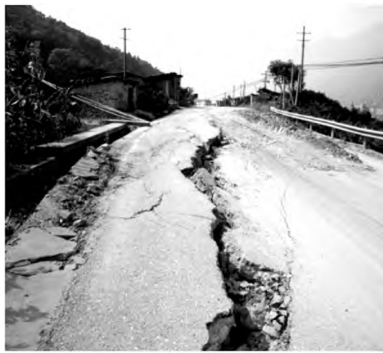
图 3 滑坡中部公路右侧拉裂缝 Fig. 3 The tensile cracks in the road
