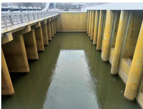
图 11 刘山泵站机组运行时前池照片
