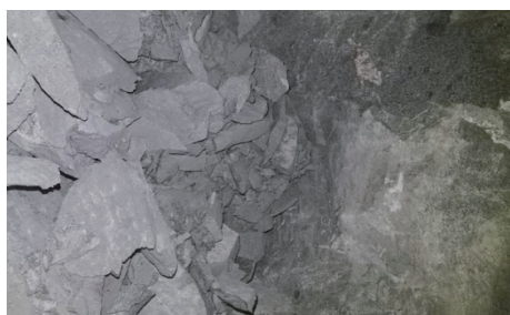
(a) 完整岩体振裂垮塌
