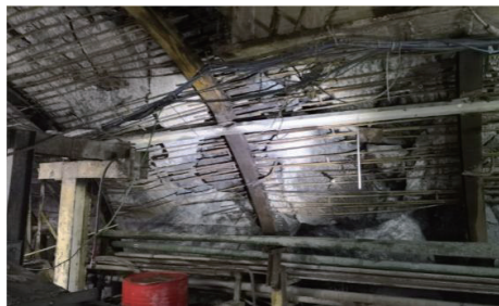
(b) 顶板围岩崩裂
